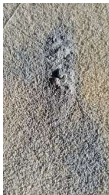
Figuur 5: aangetroffen poedervormige restanten van fosfidetabletten in breukrijst
